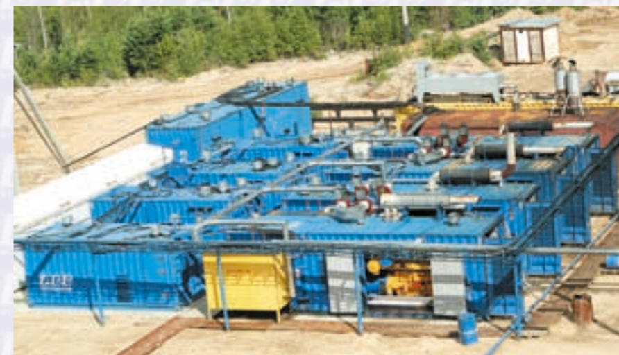
Общая мощность энергокомплексов месторождения «Соболиное» – 11,5 МВт Kapasitas Kompleks suplai tenaga di endapan “Sobolinoe” – 11,5 MW
