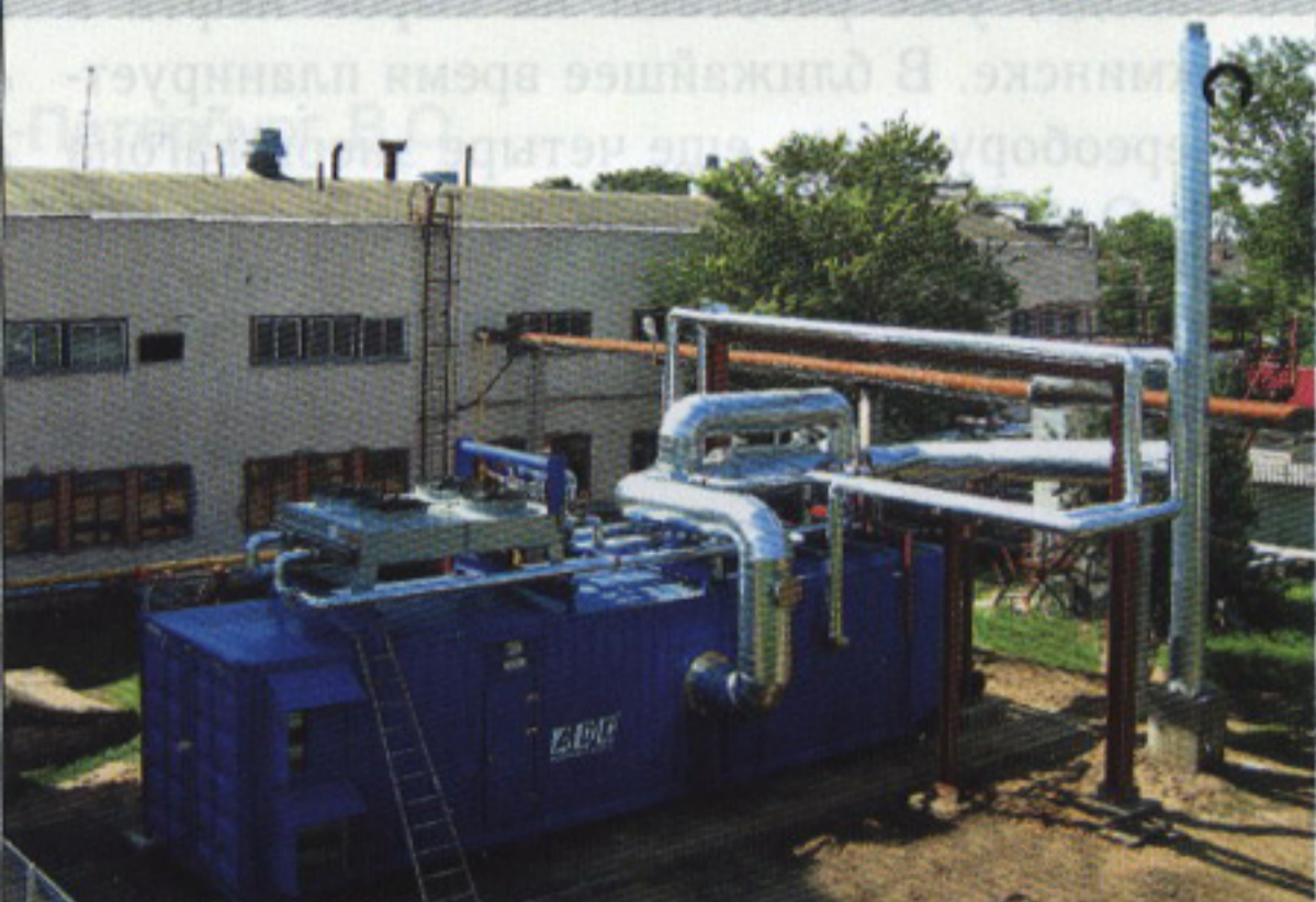
Мини-ТЭС в г. Береза на базе газопоршневой энергоустановки FG Wilson PG1250B
